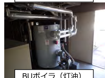
BUボイラ（灯油） ※補助対象外
