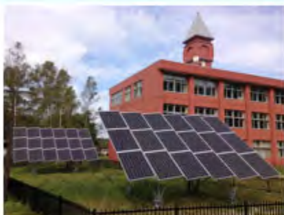
避難所に設置した太陽光発電
